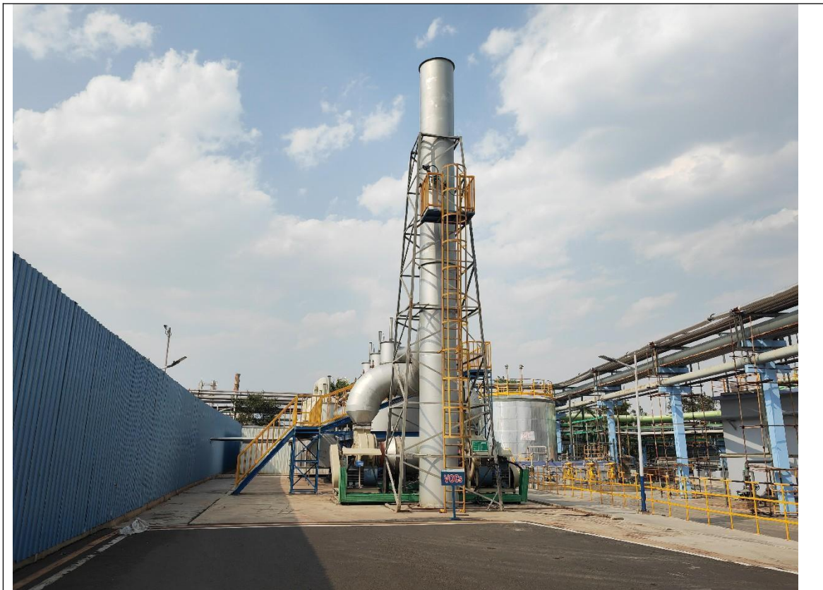
图 2-5VOCs 治理项目现场
